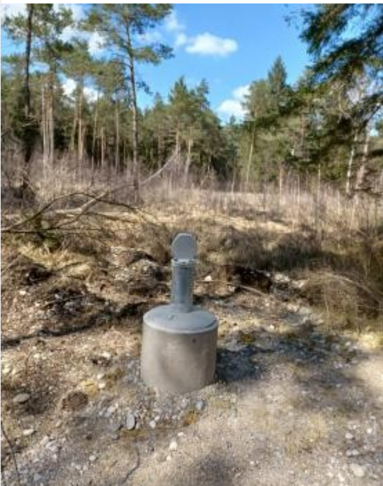
Abb. 4: Neue Grundwassermessstelle in der Nähe des Weges „Mondschein geräumt“
